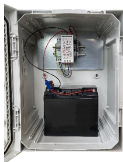
Coffret Éclairage Public
